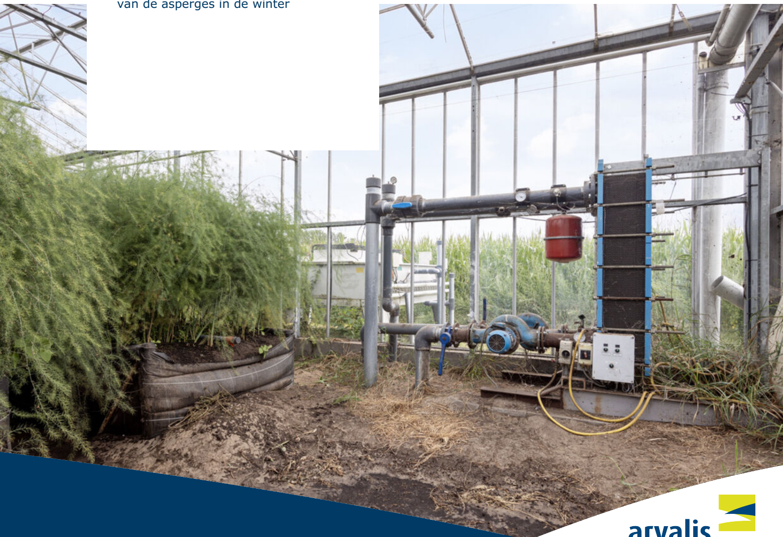
Koelinstallatie t.b.v. het terugkoelen van de asperges in de winter
